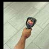
检查地板采暖，发现裂缝
