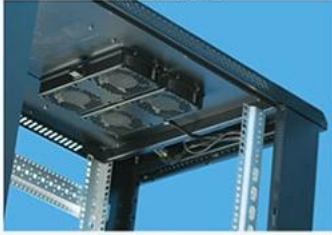
安装后机柜内部图
