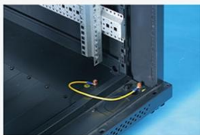
可用接地线将机柜连成一个整体
